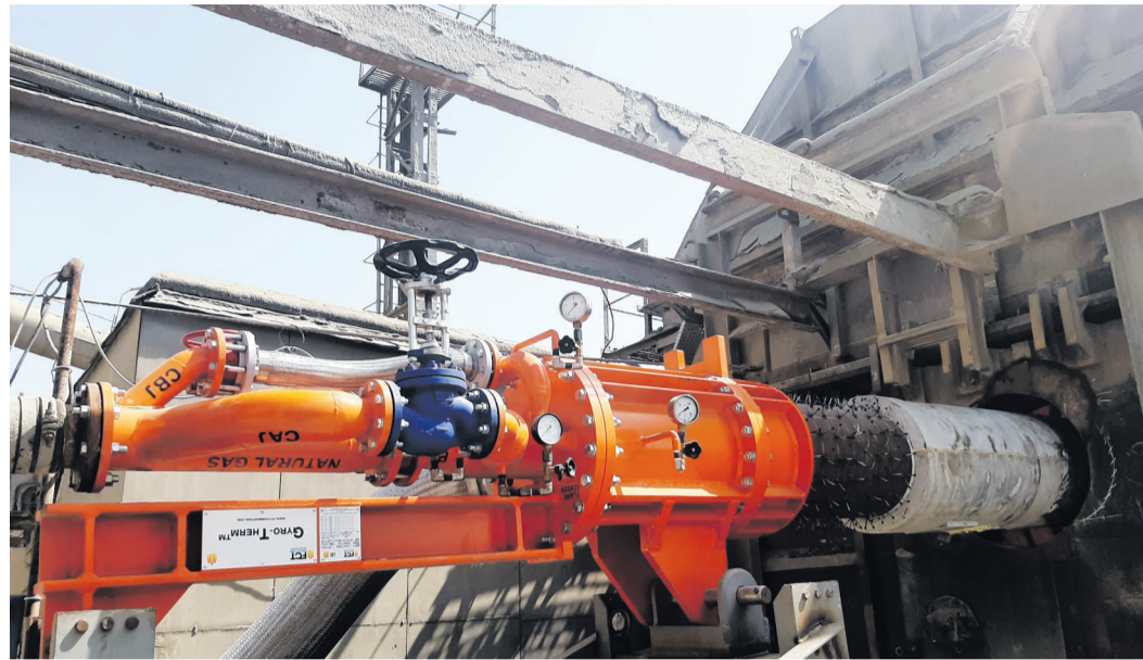
Так выглядит новая горелка печи
