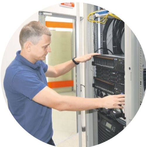
Евгений Иващенко осматривает серверное оборудование
